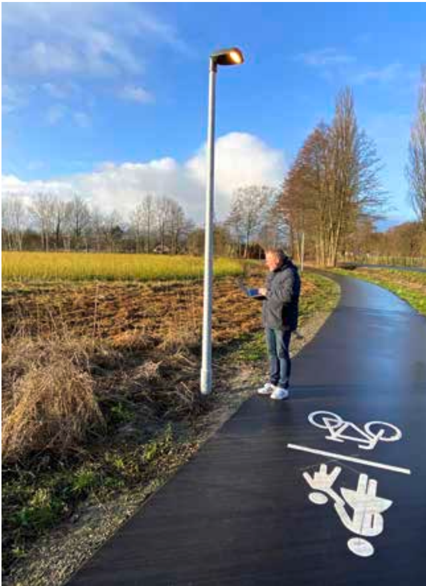
Karsten Becker, Projektleiter Sensorgesteuertes Licht bei der Firma Trilux, bei der technischen Inbetriebnahme der Leuchten.
