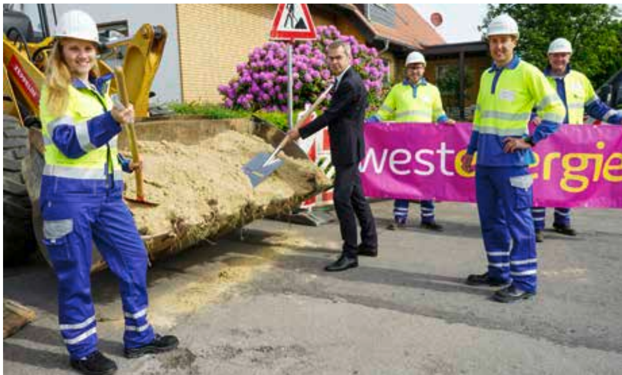
Trafen sich zum Spatenstich in Wöbbel (v.l.): Maria Kemker (Westenergie), Bürgermeister Jörg Bierwirth, Alexander Cämphausen (Westnetz), Marco Rapaic (Westnetz) und Dr. Peter Brautlecht (Westenergie).
